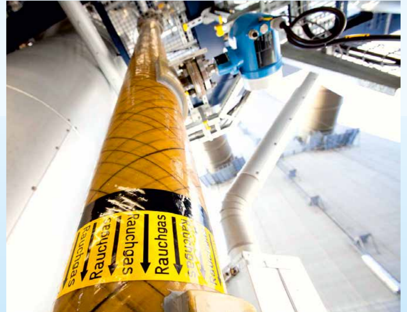
In Aberthaw/England und im Niederaußemer Innovationszentrum Kohle erprobt RWE Verfahren, mit denen CO 2 aus dem Rauchgas von Kraftwerken abgetrennt werden kann – im Interesse des Klimaschutzes.
