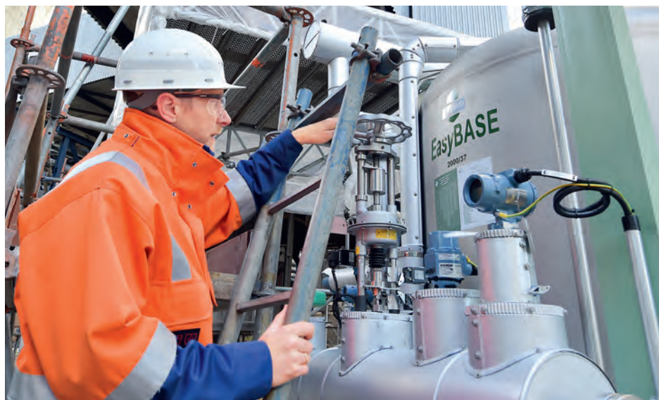
➔ EU-Projekt: Die Testanlage für „Methanol from CO 2 “ wird im Innovationszentrum Kohle im Kraftwerk Niederaußem gebaut.
