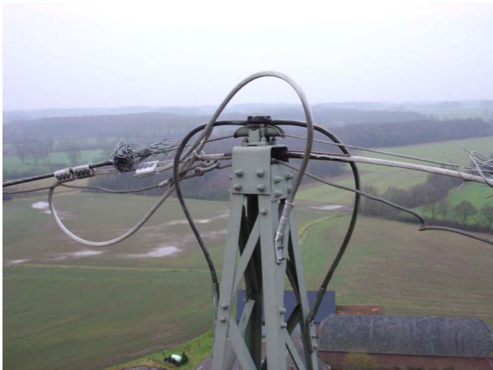
Bild 3: Durch Schneelasten gerissene Aluminiumlitzen des Erdseils, BL4307 Hanekenfähr – Gersteinwerk (380 kV), Mast Nr. 132, 08.01.2006.
