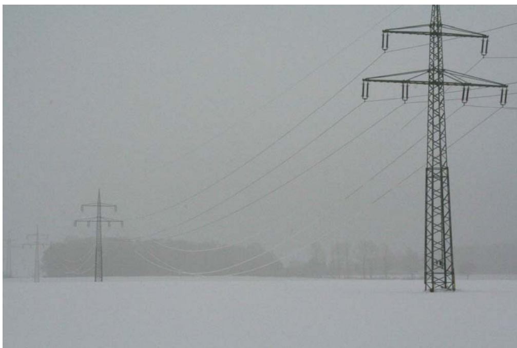
Bild 2: Durch Schnee- und Eislasten tief hängende Hochspannungsleitungen, BL1503 Gronau – Coesfeld (110 kV), östlich von Legden, 28.11.2005.
