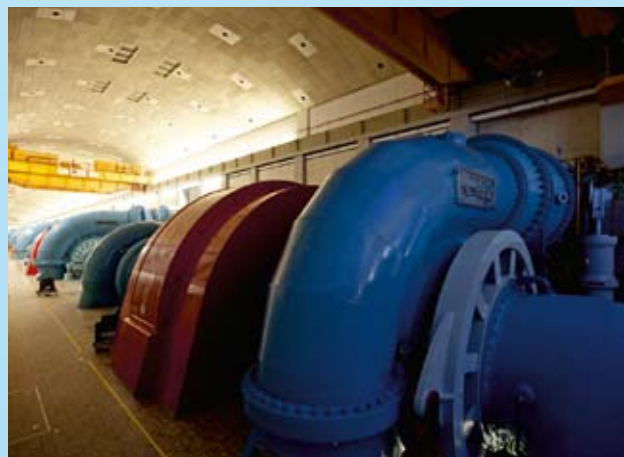
Turbinenhalle des Pumpspeicherkraftwerks Vianden
