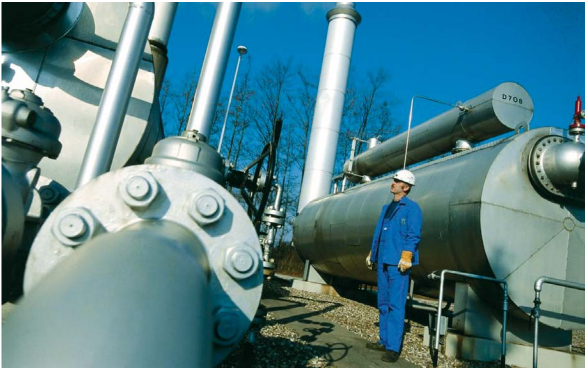
Innovative Techniken bei der Gastrocknung steigern die Effizienz des Erdgasspeichers
