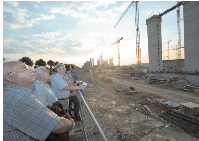
Mehr als 40 Besucher verfolgten die erste Bürger-Info auf der Baustelle. Dort hatte die Gruppe einen guten Blick auf den Baufortschritt, unter anderem bei den Treppentürmen und dem ersten Kühlturm.
