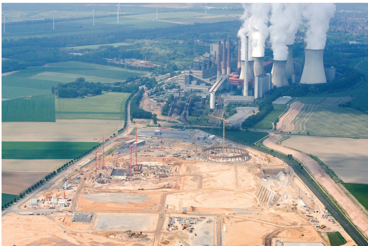
Die BoA-Baustelle wird über das Altkraftwerk in Neurath mit Strom versorgt. Zwei voneinander unabhängige Leitungen liegen jeweils um die beiden künftigen Kraftwerkstürme und Kesselhäuser.
