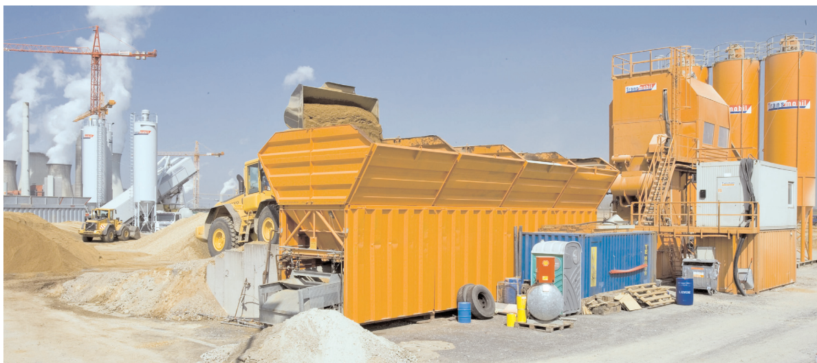
In der Mischanlage wird die richtige Betonrezeptur zusammengestellt. Auf der Baustelle kommen insgesamt drei solcher Anlagen zum Einsatz.
