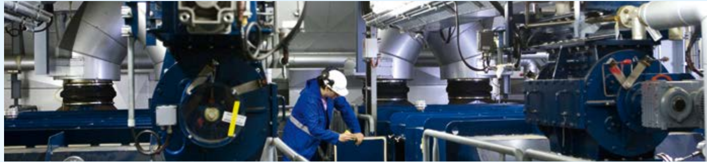
Innenansicht einer Wirbelschichttrocknungsanlage.
