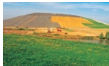
Beerwalde – выполнение работ по рекультивации на отвале пустых скальных пород уранового рудника в Германии
