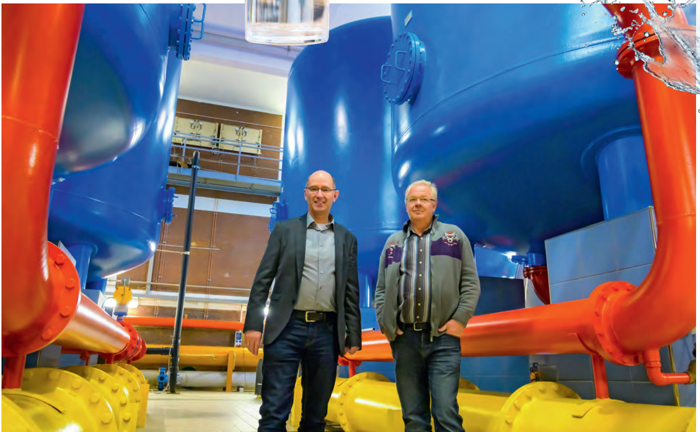
↑ FRISCHWASSER MARSCH: In der Filterhalle des Wasserwerks Grumsmühlen sorgen Geschäftsführer Reinhold Gels (links) und Wassermeister Klaus Acker für die Aufbereitung von über fünf Millionen Kubikmetern Grundwasser pro Jahr.
