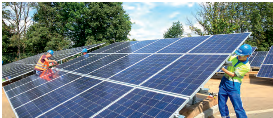
↓ KILOWATT statt Pferdestärken: Auf der ehemaligen A4 wurden 2.820 Solarmodule installiert.
