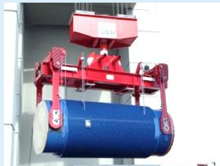
Einschleusen in das Reaktorgebäude
