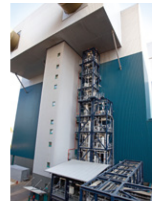
Die CO 2 -Wäsche entfernt Kohlendioxid aus dem Rauchgas.
