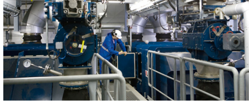
Innenansicht einer Wirbelschichttrocknungsanlage
