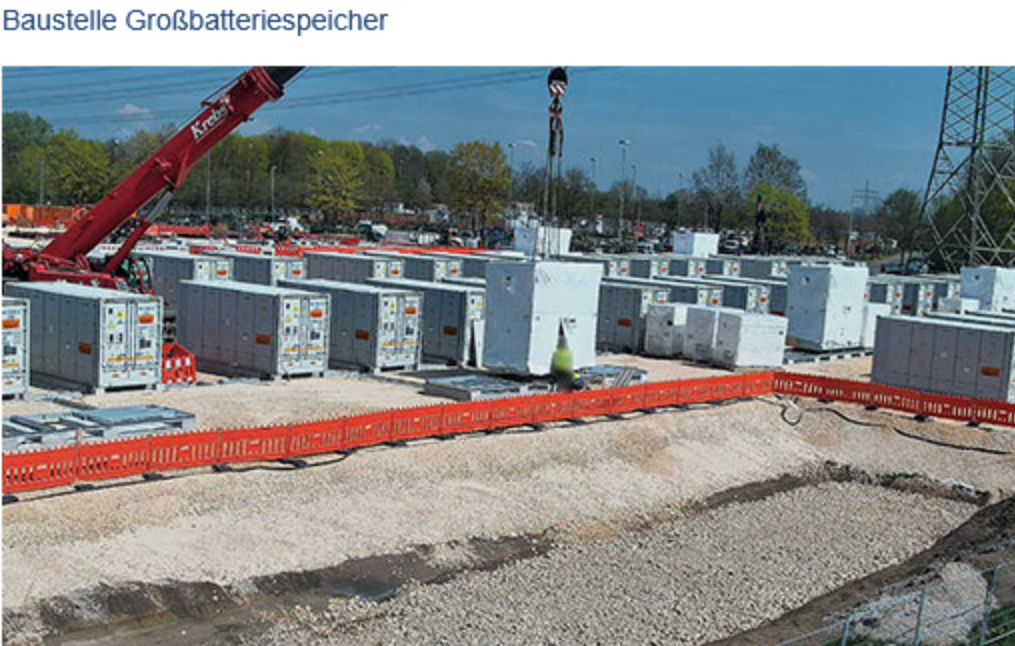
Aufbau der Batteriecontainer
