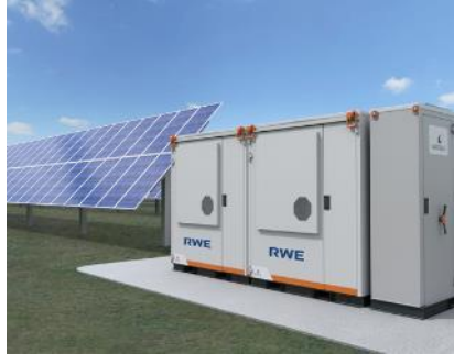
Batteriespeicher in Kombination mit Solaranlagen
