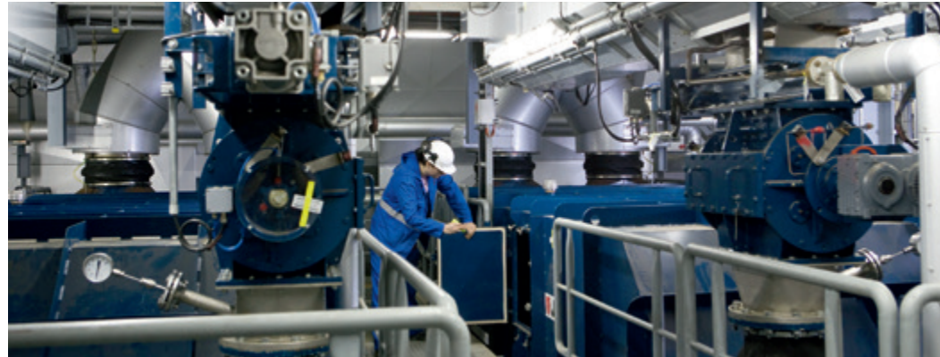
Innenansicht einer Wirbelschichttrocknungsanlage.
