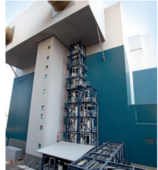
Die CO 2 -Wäsche entfernt Kohlendioxid aus dem Rauchgas.
