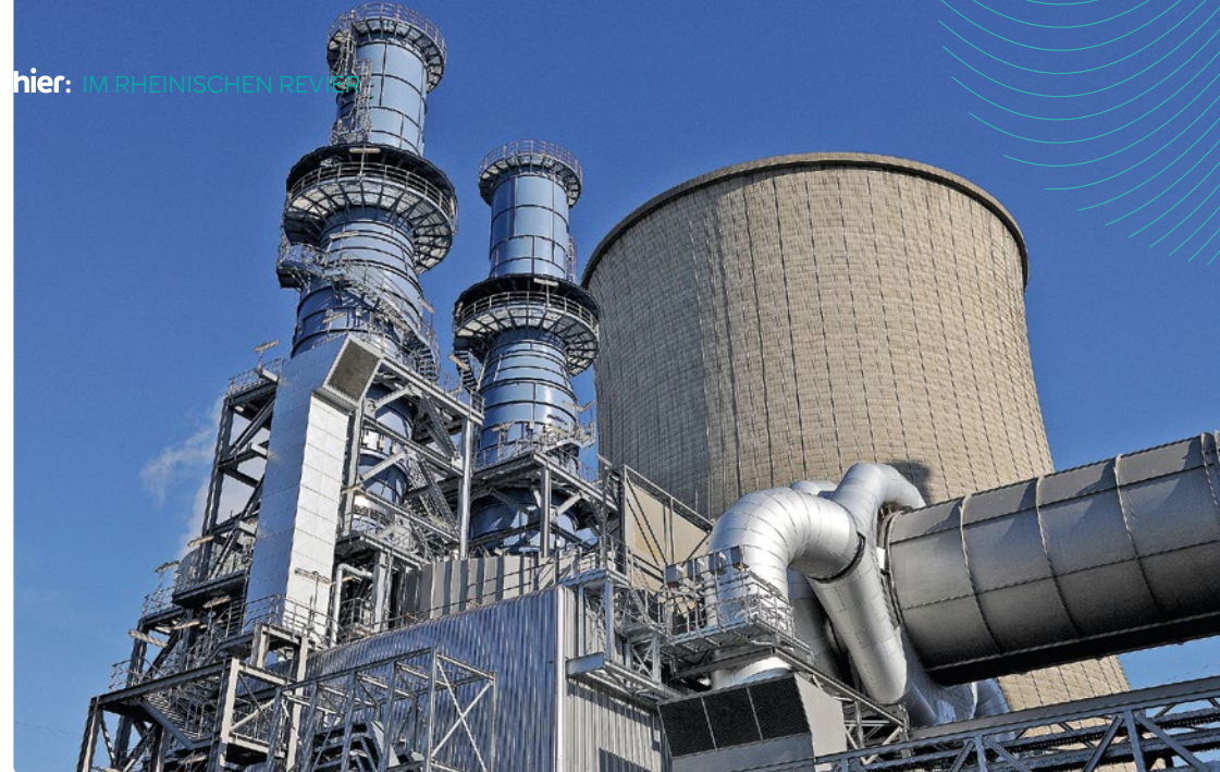
Das geplante Kraftwerkssicherheitsgesetz macht den Weg frei für neue Gaskraftwerke.
