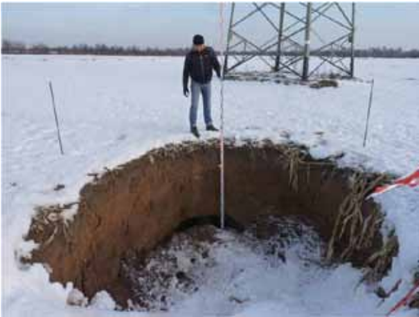
Abb. 11: Eingebrochener Mergelschacht bei Pulheim-Geyen, Januar 2010. Hinter dem Zollstock ist der Gewölbeansatz der noch intakten Kammer zu erkennen. (Foto: Horst Engel, Pulheimer Bachverband)
